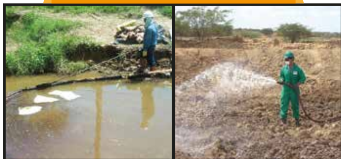
Tratamiento para aguas contaminadas
